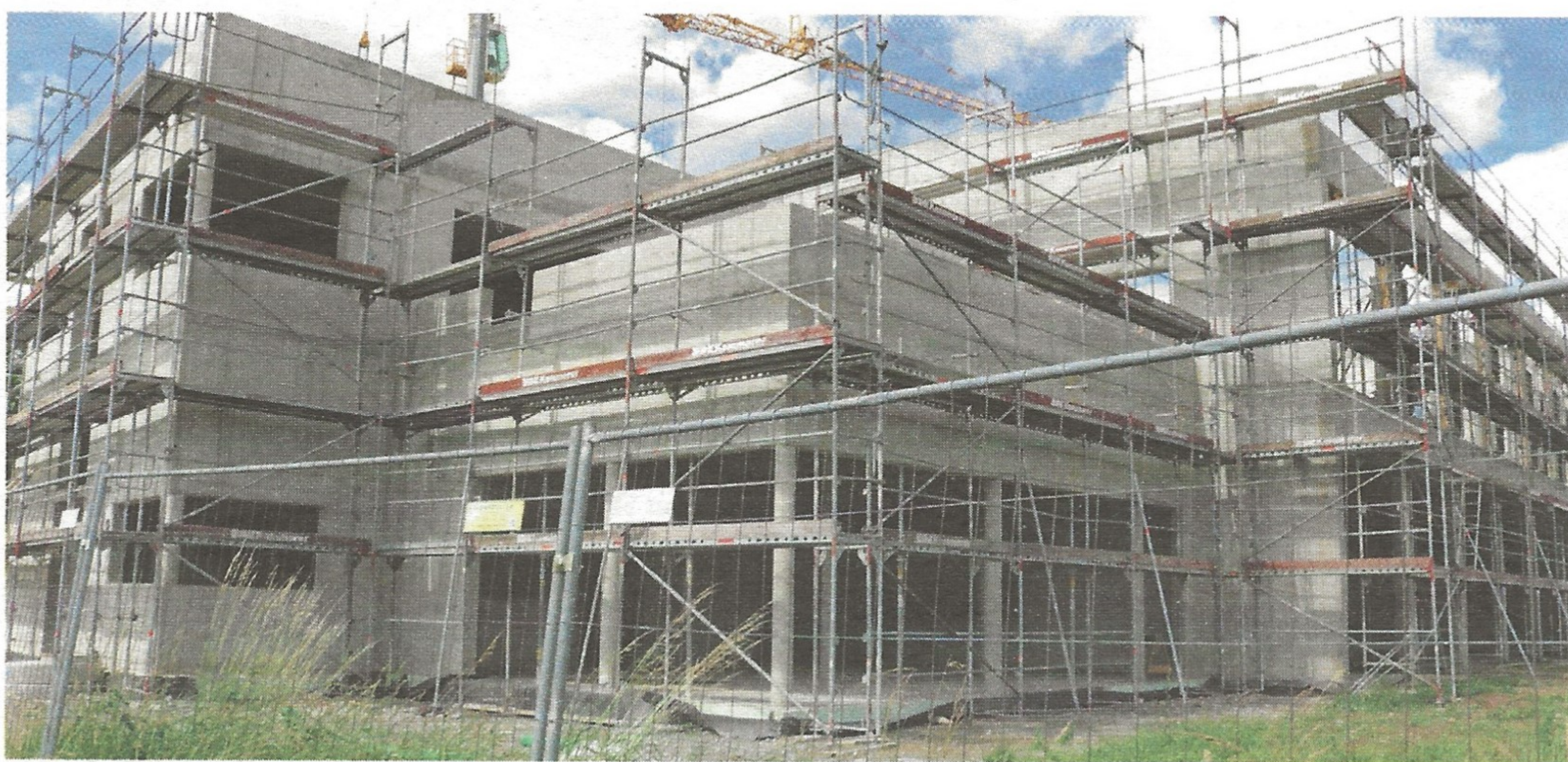
Der Rohbau des neuen Vereinszentrums des TSV steht bereits. Derzeit läuft der Innenausbau auf vollen Touren, denn im Frühjahr soll die Eröffnung stattfinden. Foto: prf
